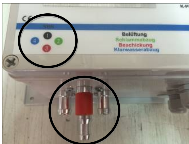
Imagen 7: entronques de conexión de cuadro eléctrico
